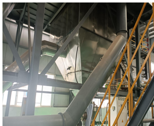
破碎粉尘处理设施（TA002）
