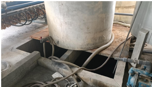
项目污水处理站
