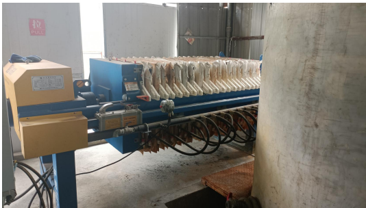
项目污泥压滤机
