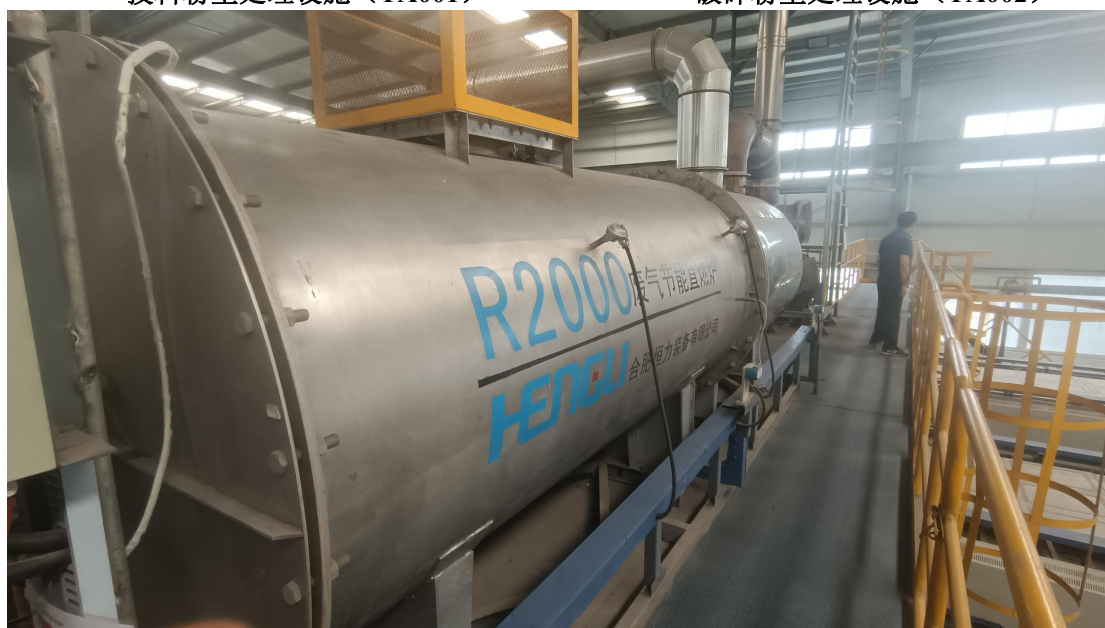
烧结废气处理系统（TA003）
