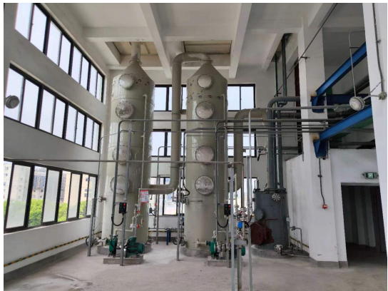
二级水喷淋处理
