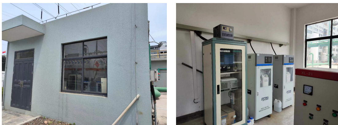
图 10-4 污水排放口废水在线情况
