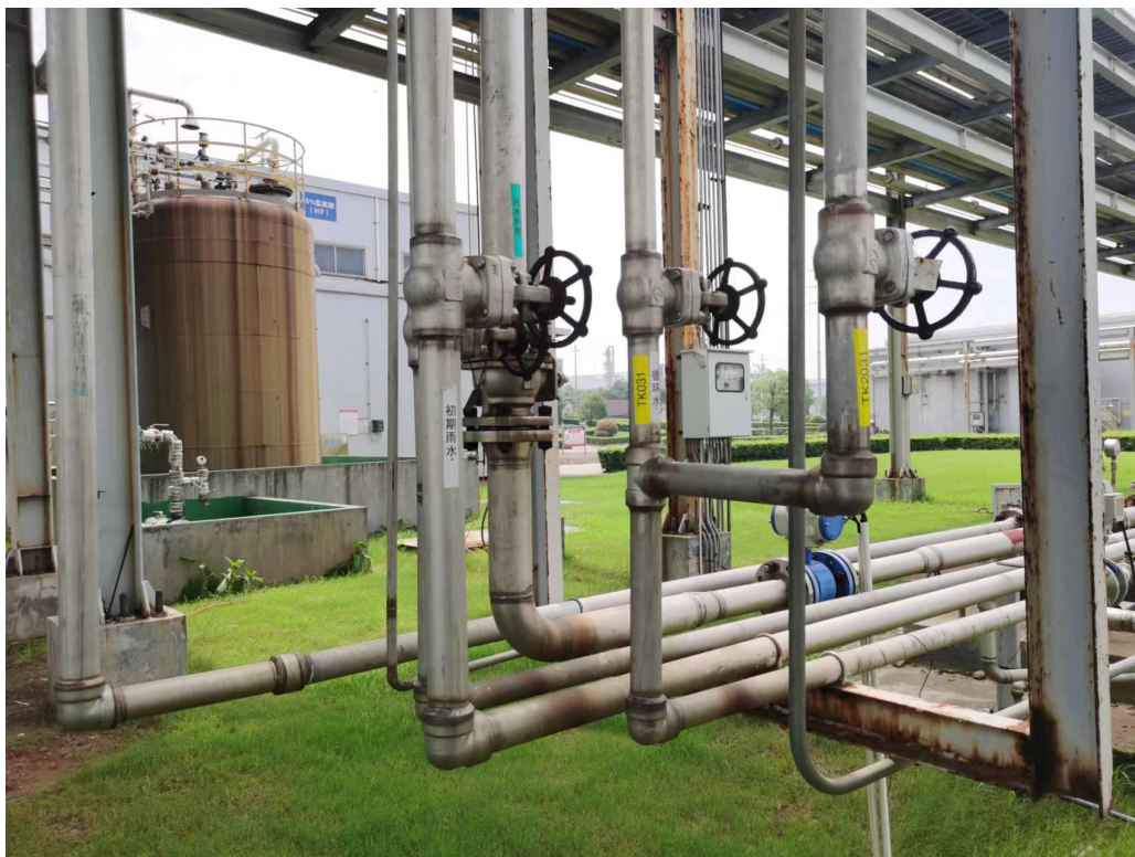
图 4-1 生产废水架空管线现场照片
