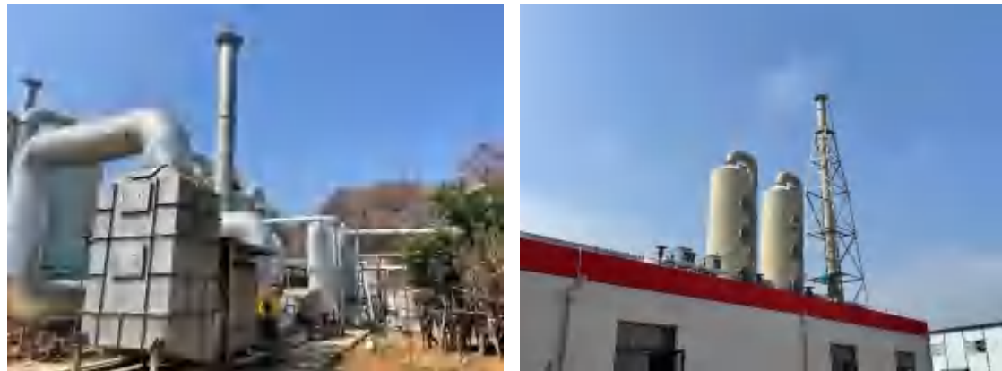
废气处理设施（1）
