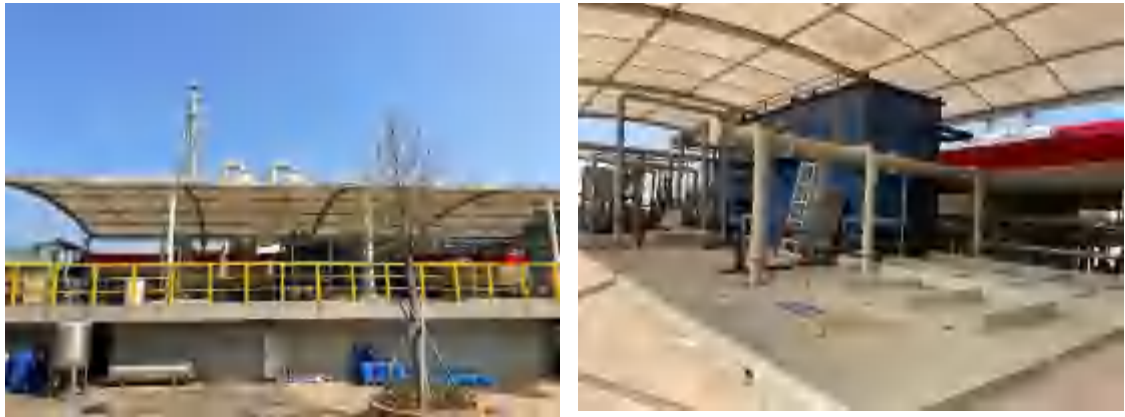
图 4-2 项目污水处理设施现场图片
